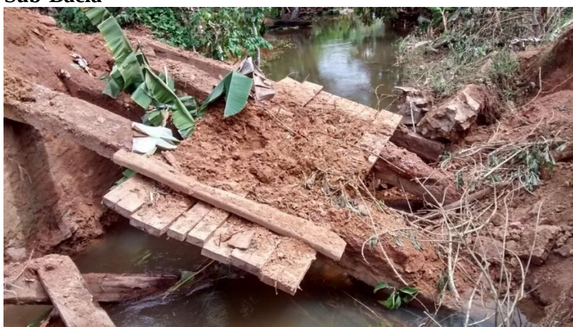
Figura 9- Ponte destruída após chuvas de dezembro de 2015, parte superior da Sub-Bacia
